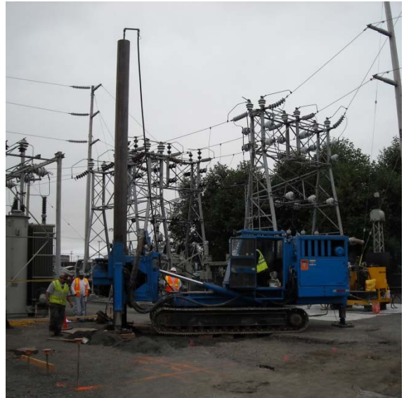
Arcata Substation 20" TGIP-Arcata, CA
